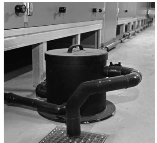
Zentraler Siphon für Kondenswasser.
