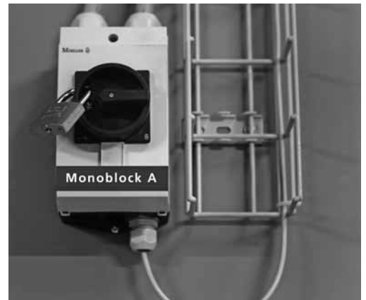
Sicherung der Anlage mit persönlichem Vorhängeschloss.
